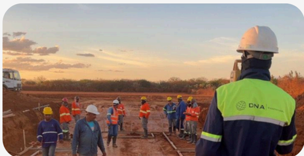
ENEL POWER GREEN - Parque eólico
